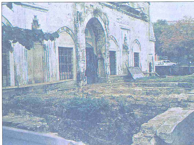
İbrahim Paşa Camii'nin yıkılmış durumdaki son cemaat yeri
